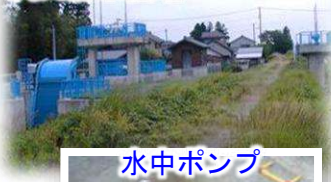
沢田排水機場
