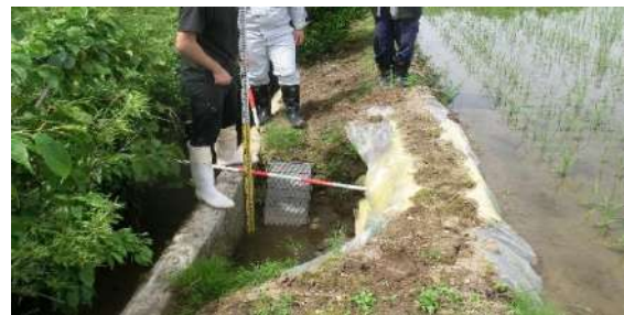
▲水路脇に発生した大きな陥没
