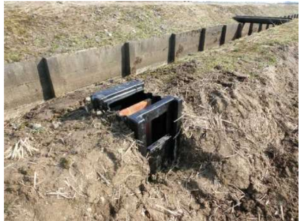
田んぼダム柵設置状況
