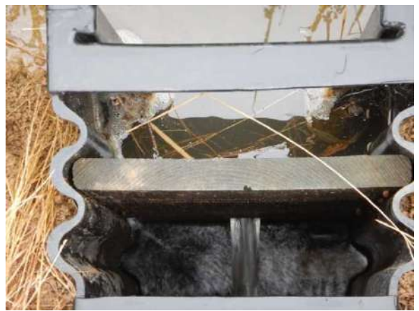
排水量調整状況
