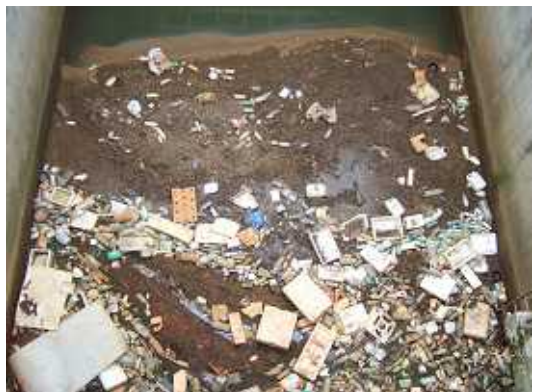
旧小里川サイホンに浮遊する大量のゴミ
